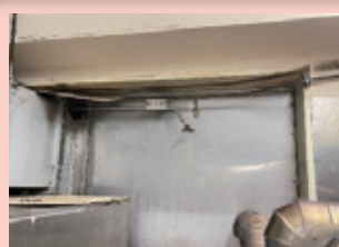
排煙窓を固定し 排煙面積が不足している
