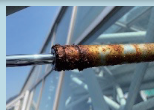
ダンパーの腐食
