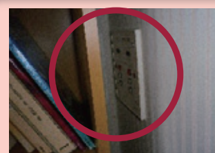
操作ボックスの前に 棚が設置され操作不能
