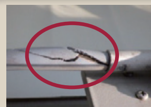
ワイヤー配管部分の破損
