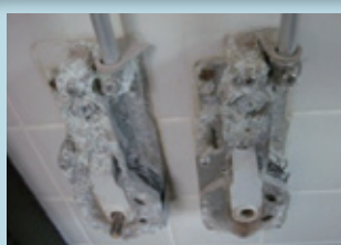
温浴施設に設置された 操作ボックスの腐食
