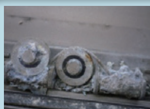
塩害による 滑車の腐食
